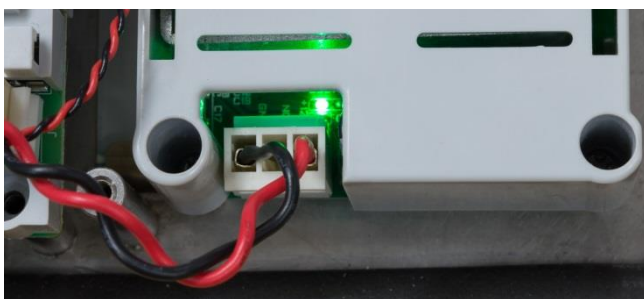
Figura 5-4: LED 12 VCC sull'alimentazione
