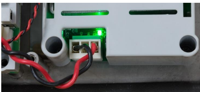
Figura 5-4: LED de 12 VCD en la alimentación de energía
